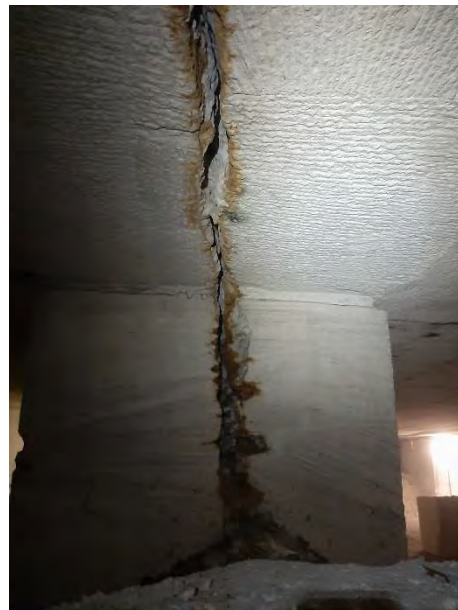
Figure 6 : Fissuration géologique avec développement de karst
