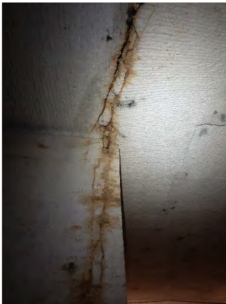
Figure 5 : Fissure géologique ouverte avec remplissage argileux
