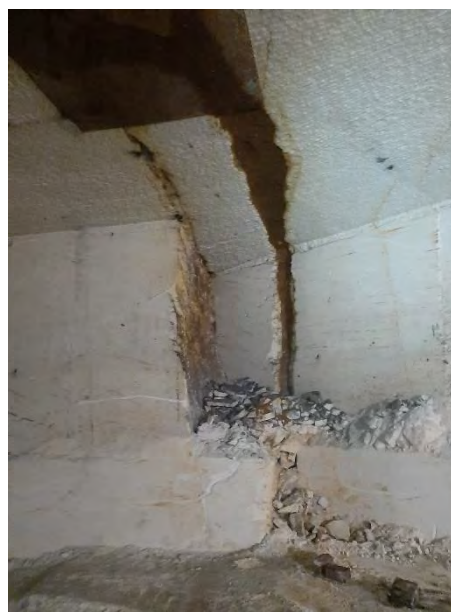
Figure 12 : Karst se développant au droit d'une fissure géologique (toit protégé par un grillage)
