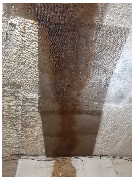
Figure 11 : Karst se développant au droit d'une fissure géologique (protégé par un grillage)
