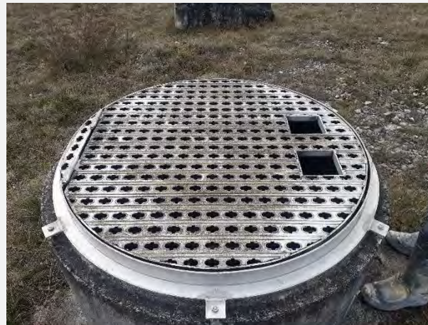
Grille du conduit d'aération à l'extérieur du site
