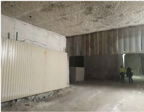
Porte hermétique à lanières de PVC entre les deux parties du site
