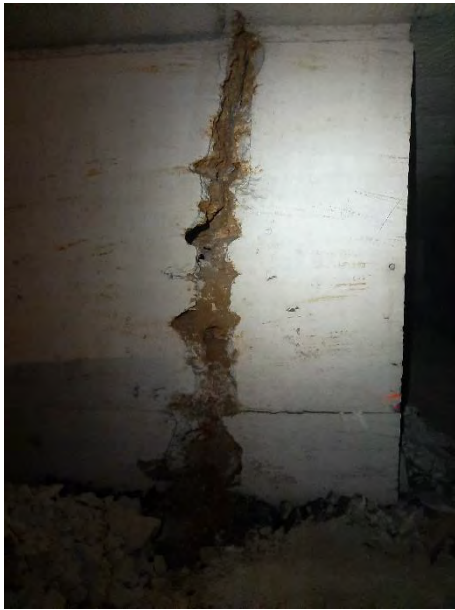
Figure 7 : Fissuration géologique avec développement de karst
